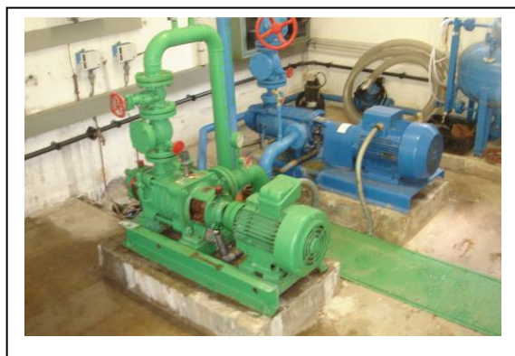
Station de pompage de la source
